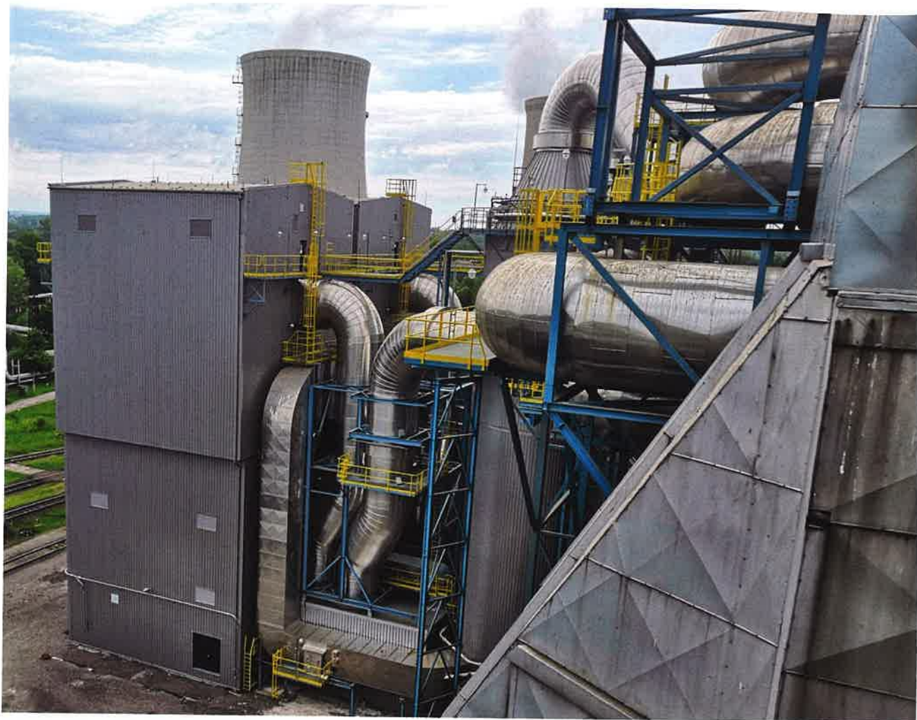
Odsíření kotle K13 začalo v roce 2017 a stálo půl miliardy korun
